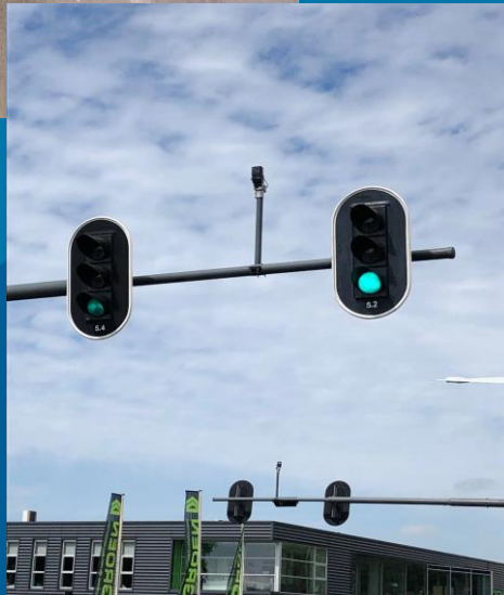
Tussen fase Camera's voor detecteren verkeer
